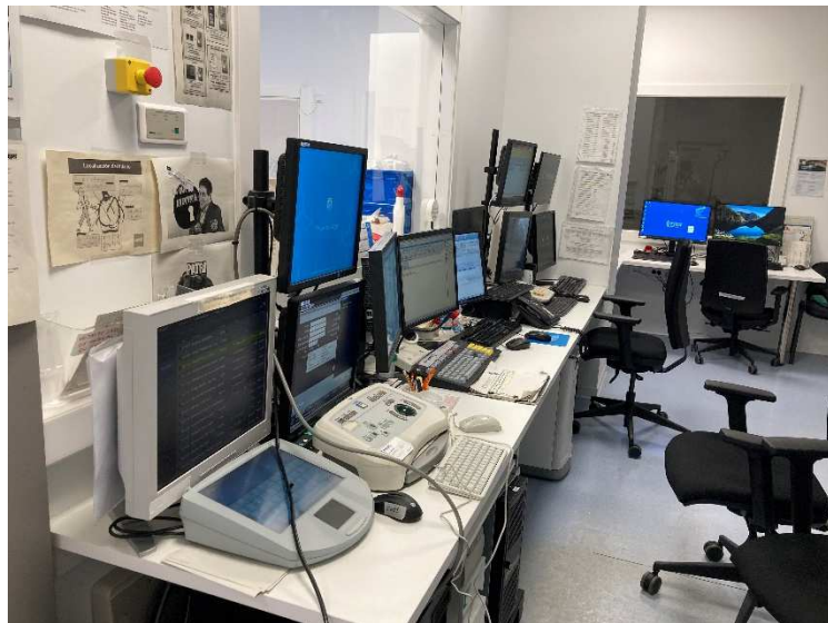
Sala de control del quirófano de Hemodinámica
